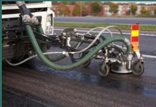
Tar bort asfaltsblödningar
